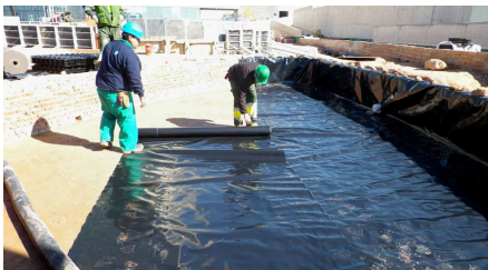
En las áreas de siembra, delimitadas por muros de piedra, se instaló, en primer lugar, lámina antirraíces WSF 40.
